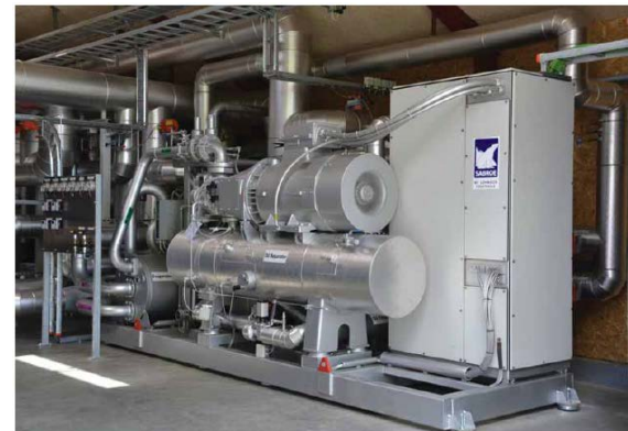
1 MW heat pump in Brædstrup
